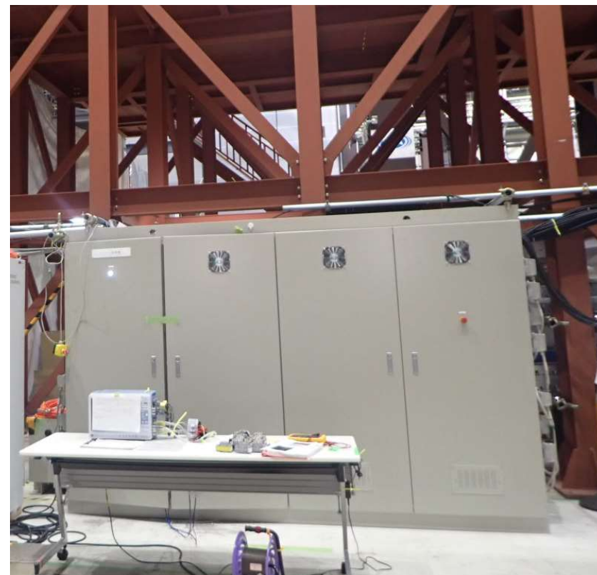
アーム制御盤
