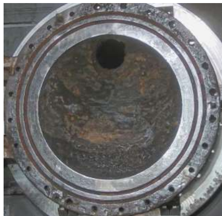
【X-6ペネトレーション内面の堆積物残留状態】
